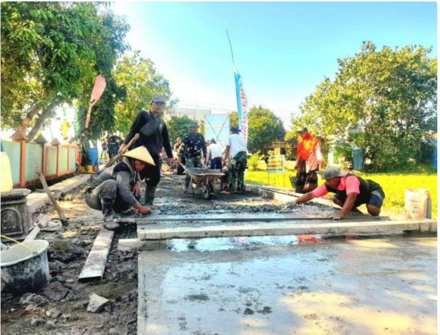
Satgas TMMD Reguler Ke-117 Kodim 0717/Grobogan Bersama Warga Desa Cangkring Melaksanakan Pengecoran Jalan
